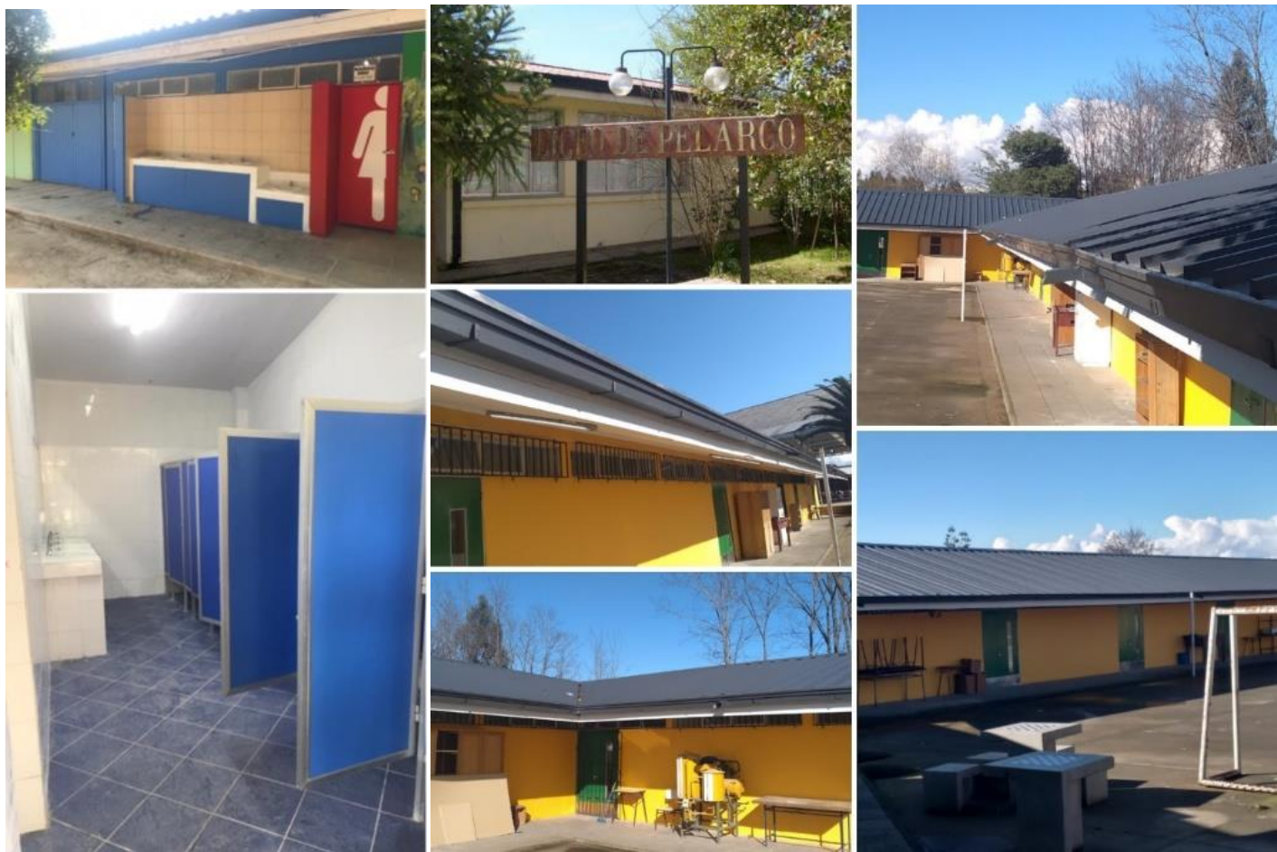
Fotografías Mejoramiento de Infraestructura en Centro Educativos de la Comuna de Pelarco 2020.
